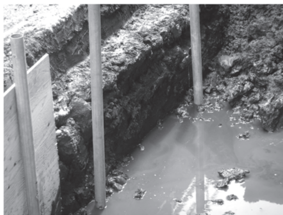
44図 C区浸透柵設置部分擁壁基礎コンクリート検出状況
