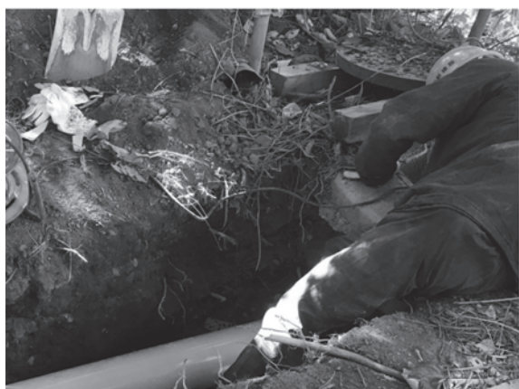
47図 D区排水柵接続部壁堆積状況北から
