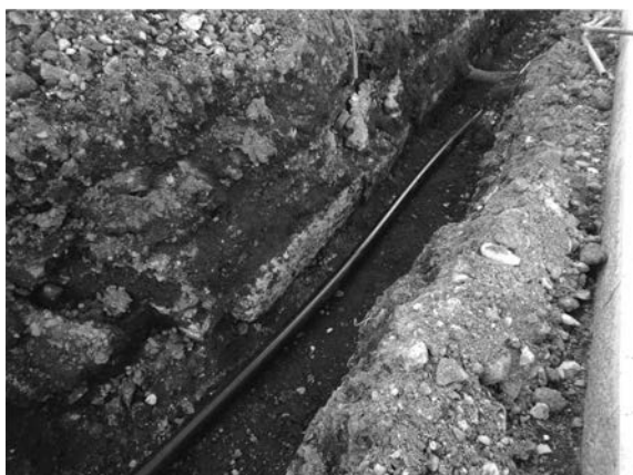
22図 給水管設備地点C区②大谷石 検出状況（北東から）
