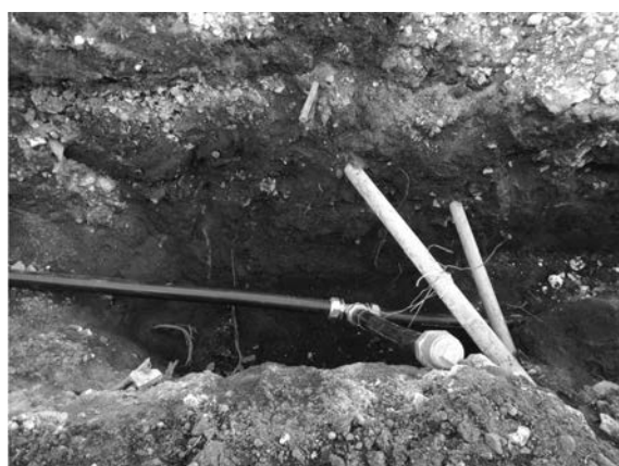
23図 給水管設備地点E区③堆積状況（南から）
