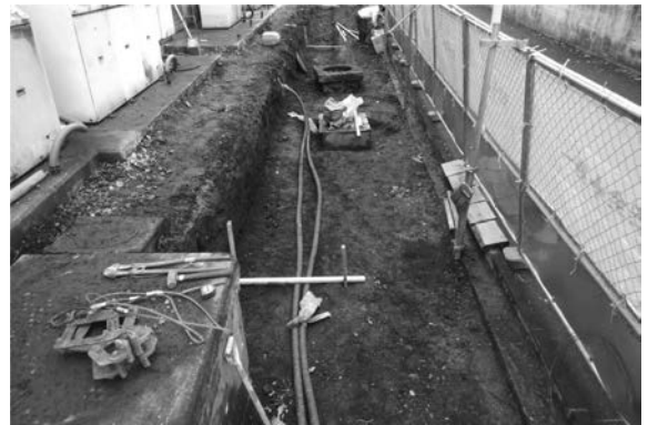
81図 北側囲障改修地点E区西側掘削底面確認状況（東から）
